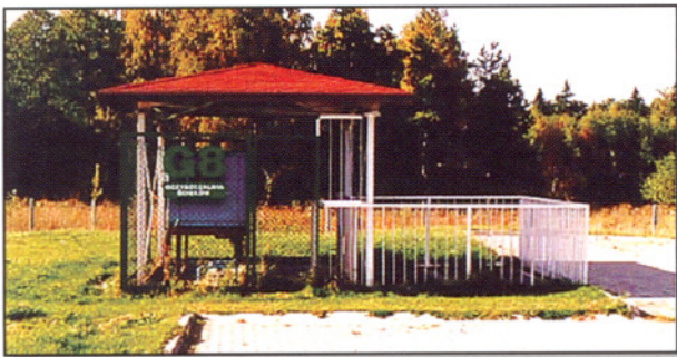
Część mechaniczna i biologiczna hydrobiologicznej oczyszczalni ścieków
